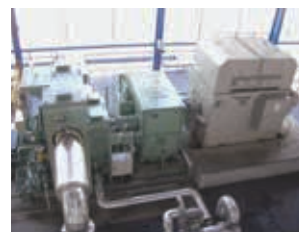
インドネシア・モジョケルト工場の蒸気タービン発電設備。ガスタービンの廃熱を回収した蒸気で発電を行い、CO 2 を約20%削減。
